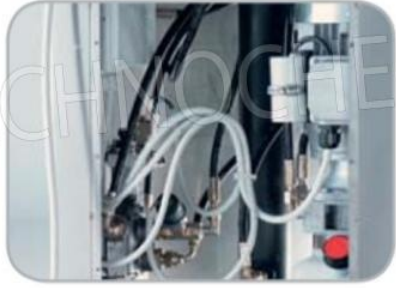
Particolare centralina e comandi
